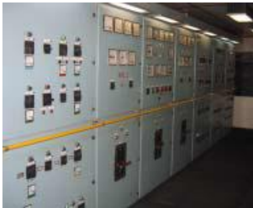
Fot. 1 Rozdzielnica główna na statku morskim
